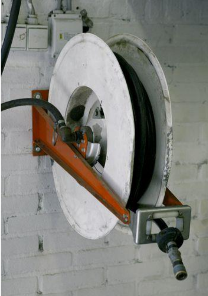
Figuur 14-22: De haspelslang is keurig opgerold en geeft geen rotzooi op de werkvloer.
